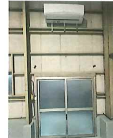
1 階裏口側エアコン
