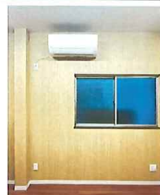
2 階洋室エアコン
