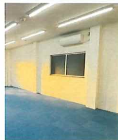
2 階事務所エアコン
