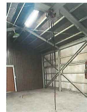
2 階手動クレーン
